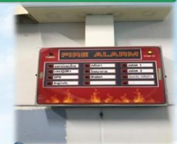
▶ ระบบแจ้งเตือนอัคคีภัย
