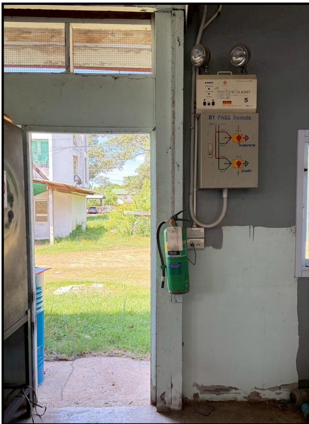
โคมไฟแสงสว่างฉุกเฉิน บริเวณห้องเครื่องกำเนิดไฟฟ้า
