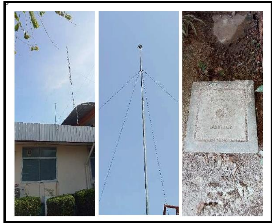
หลังคาอาคารอำนวยการ ติดตั้งระบบป้องกันฟ้าผ่าสิ่งปลูกสร้างแบบ Early Steamer Emission
