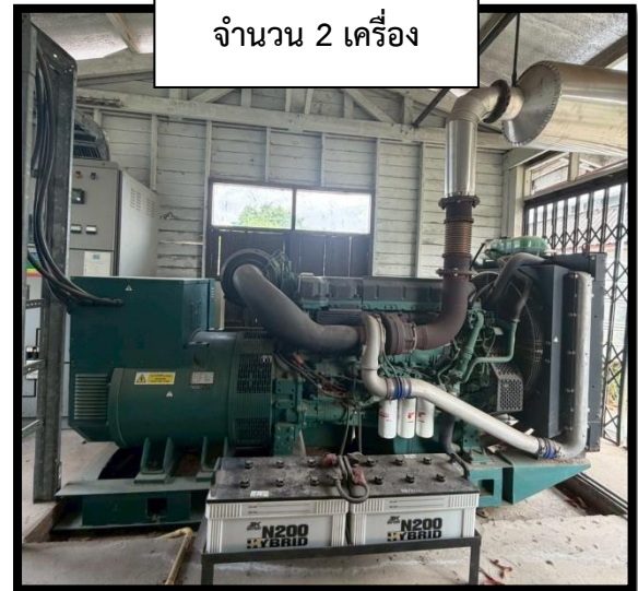
เครื่องกำเนิดไฟฟ้า
